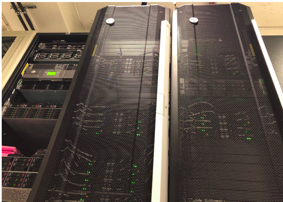
Figura 4 – Fotografia da sala de servidores da Belgingur.
